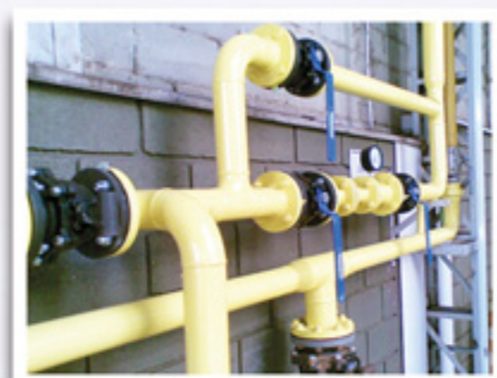
Tubulação de Gás
